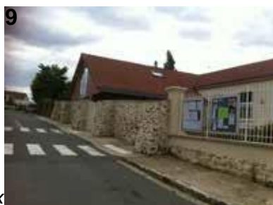
Mur rue de Meaux
